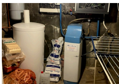
optie 1: bestaand boilervat bij gasketel
